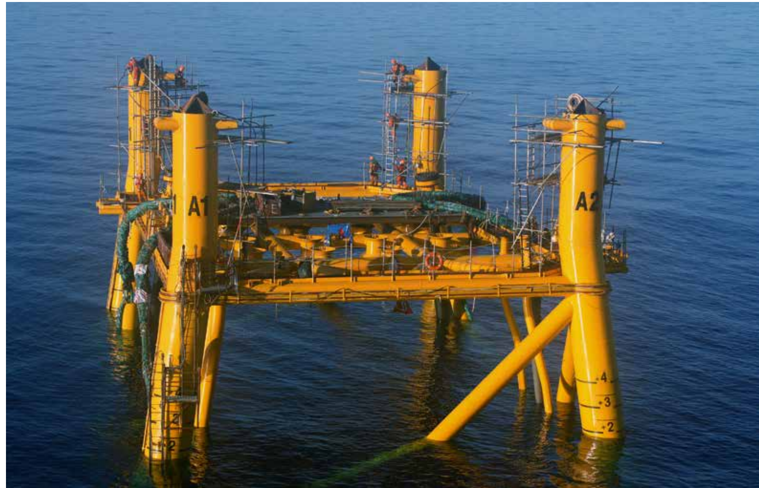
Khối trụ đỡ chờ đặt cấu kiện phía trên của giàn công nghệ mỏ Mộc Tinh
