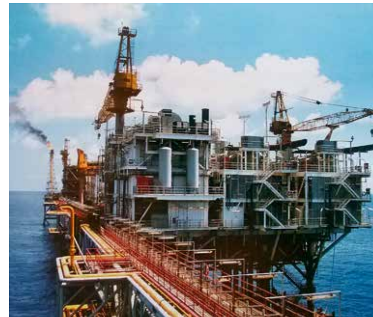
Hệ thống duy trì áp suất vỉa tại Giàn công nghệ trung tâm số 3. Ảnh tư liệu của XNLD Vietsovpetro
